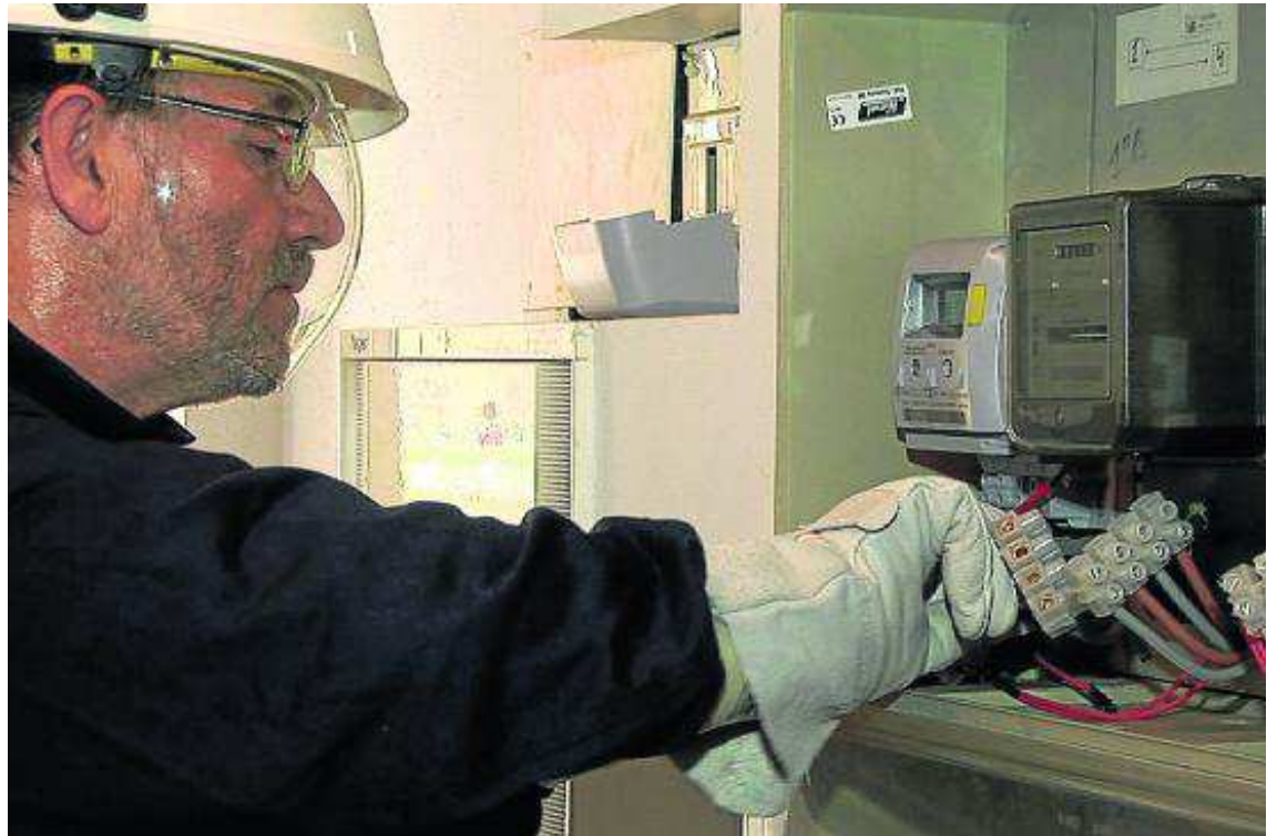
Instalación de los nuevos contadores de telegestión que permiten la facturación por horas.
