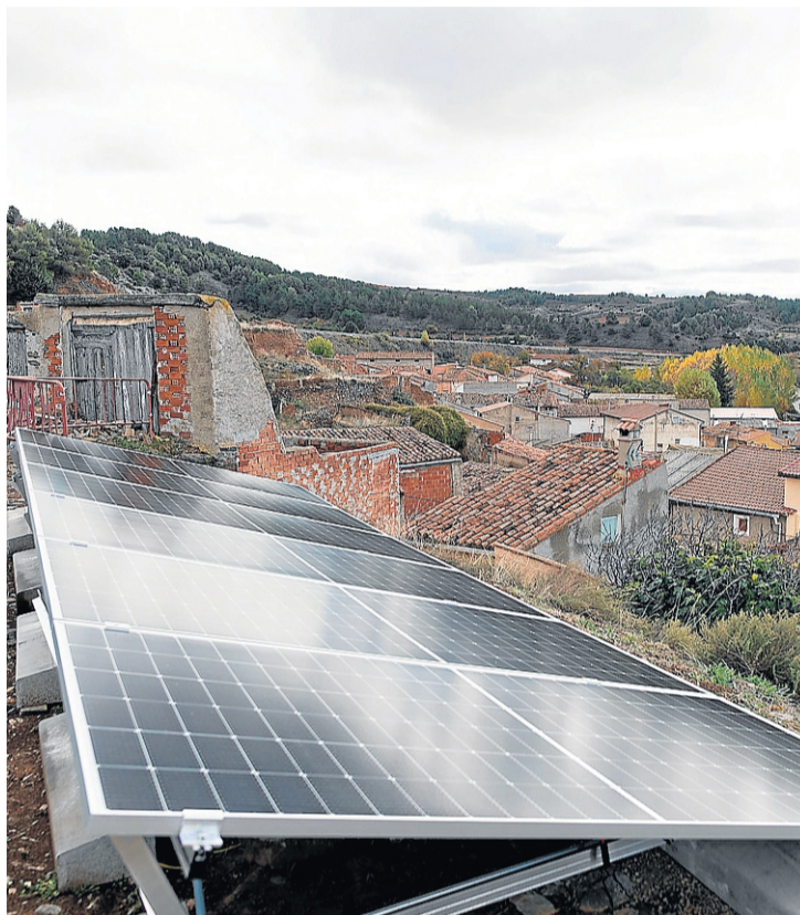
Instalación fotovoltaica en Luco de Jiloca. FRANCISCO JIMÉNEZ
